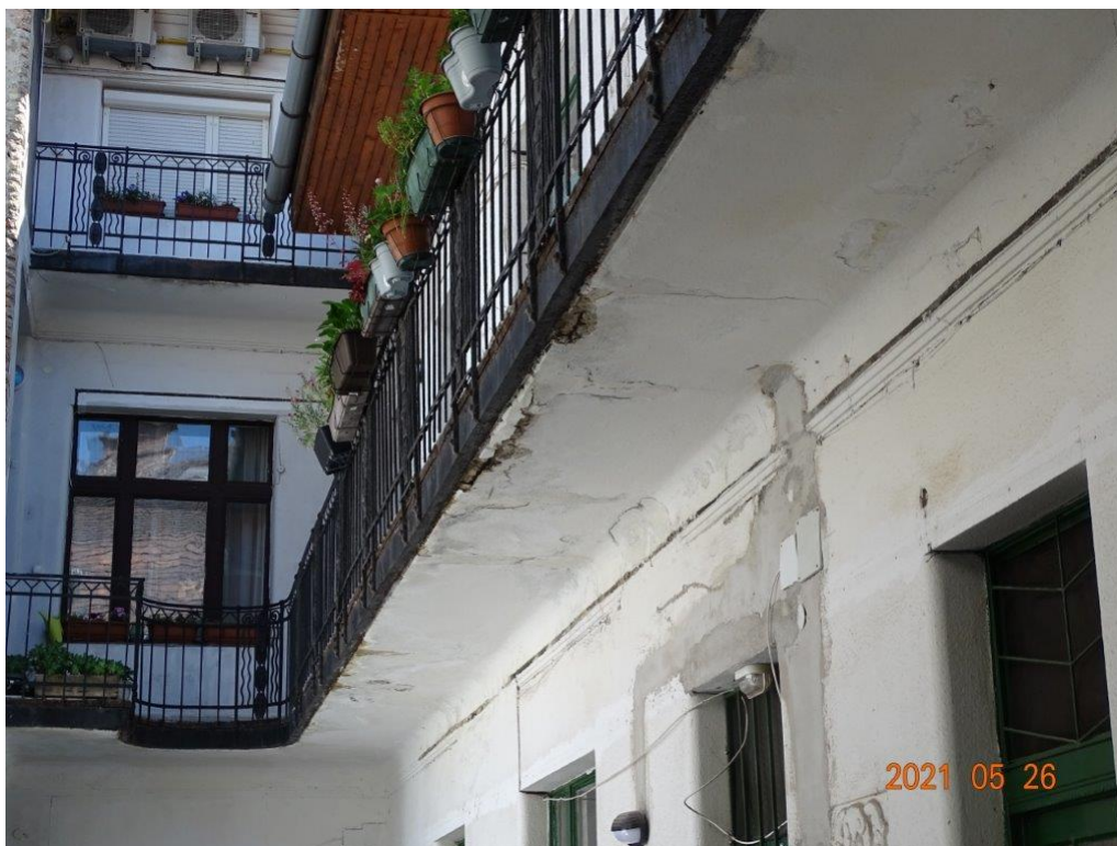
Átázott II.-III. emeleti függőfolyosó: vakolat leválások, betonvas korrodál
